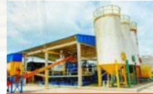
Thermal Desorption Unit
